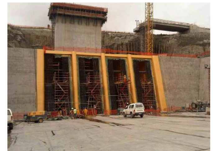
INSTALLATION DE POMPAGE-TURBINAGE DE INGULA
